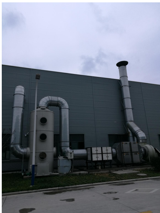
图 4-4 微波挤出废气处理设施
