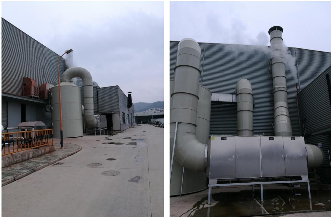
图 4-7 硫化罐废气处理设施
